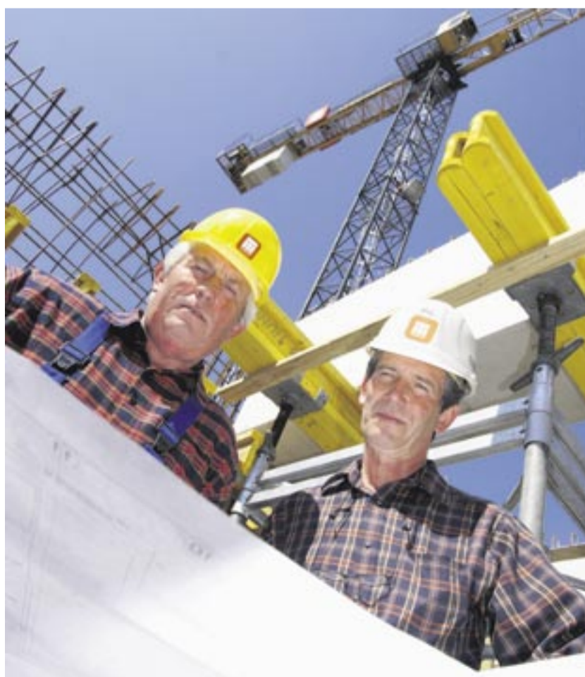
Wer auf der Baustelle improvisieren muss, weil nicht genügend Maschinen bereit stehen, der tut sich schwer. Foto: Martin Hell, Chiaro Fotografie und Design, Regensburg
